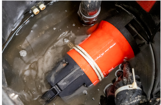
Wasser im Innenbereich des Wassersaugers
