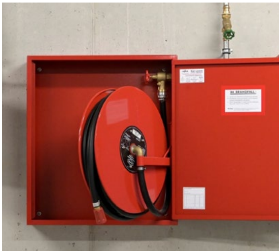
a) Wandhydrant, Typ S
