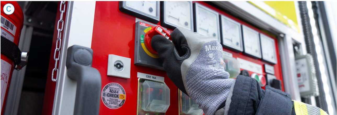
Hauptschalter am Stromerzeuger
